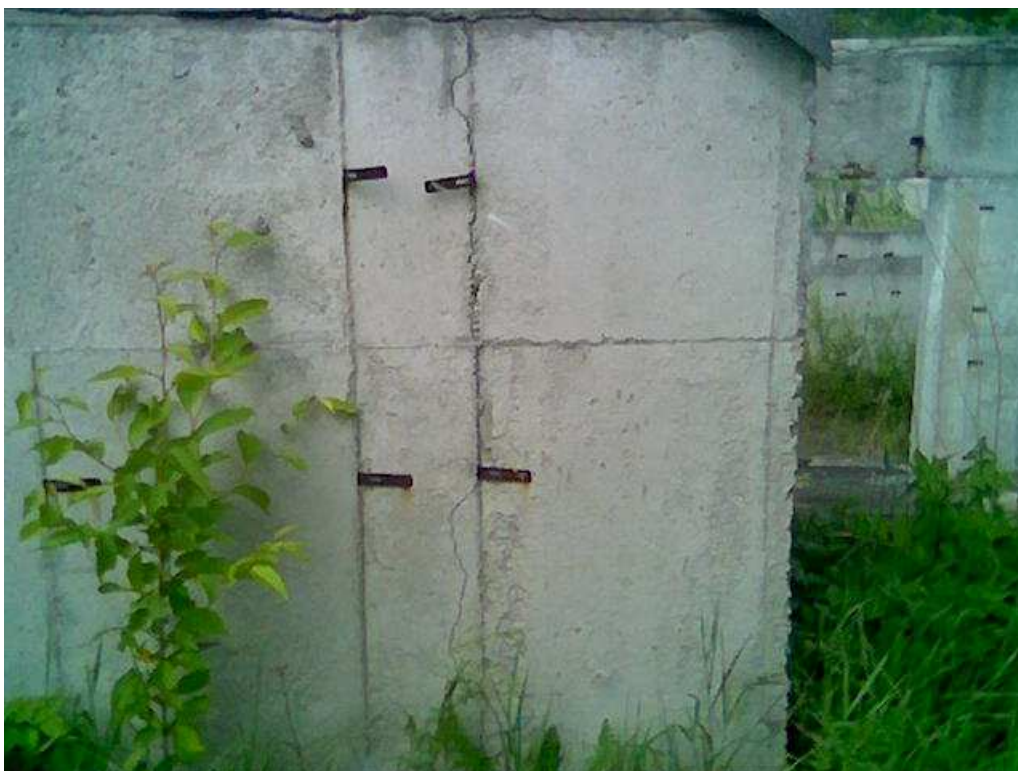
Fot. 3. Rysa pionowa na ścianie zewnętrznej wschodniej.
