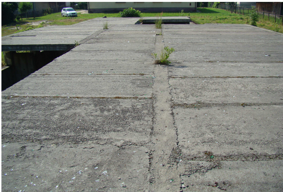
Fot. 13. Widok stropu piwnic – złuszczenia na płytach.
