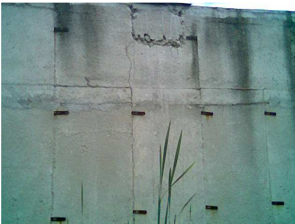
Fot.8. Mała rysa pionowa pod zalanym gniazdem pod projektowaną belkę.
