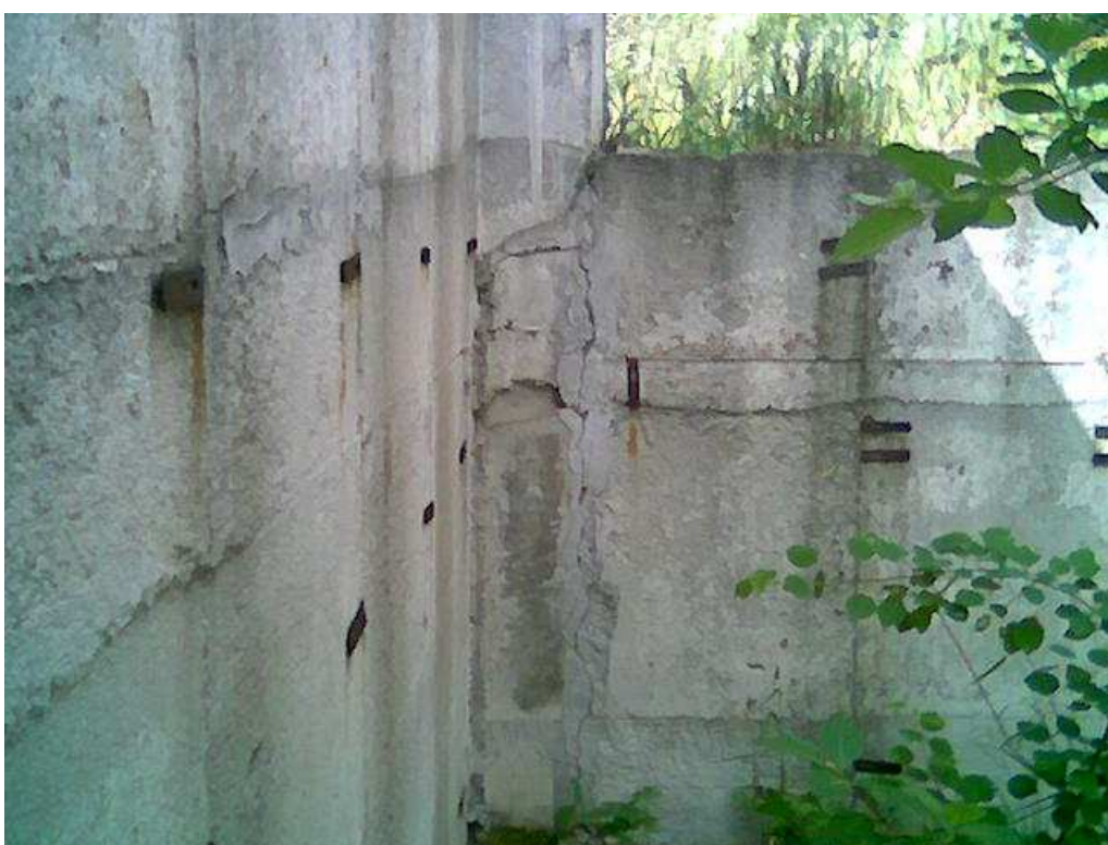
Fot. 6. Rysa pionowa pod oknem ściana zachodnia.
