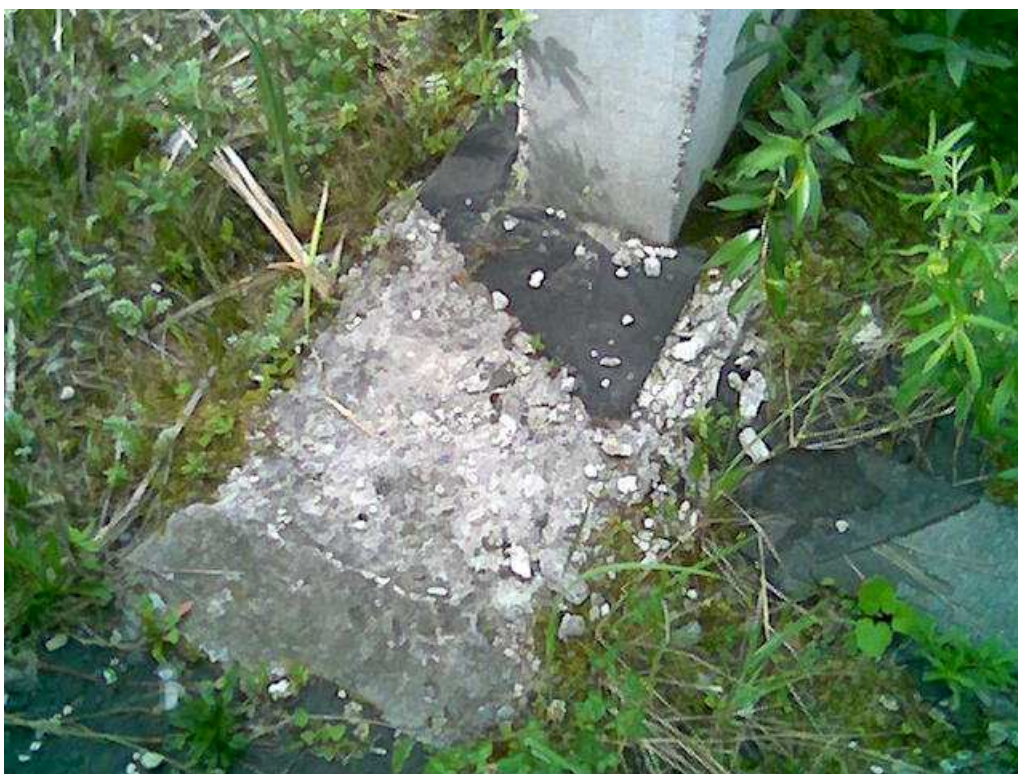
Fot. 2. Uszkodzenie izolacji poziomej i górnej warstwy ławy.
