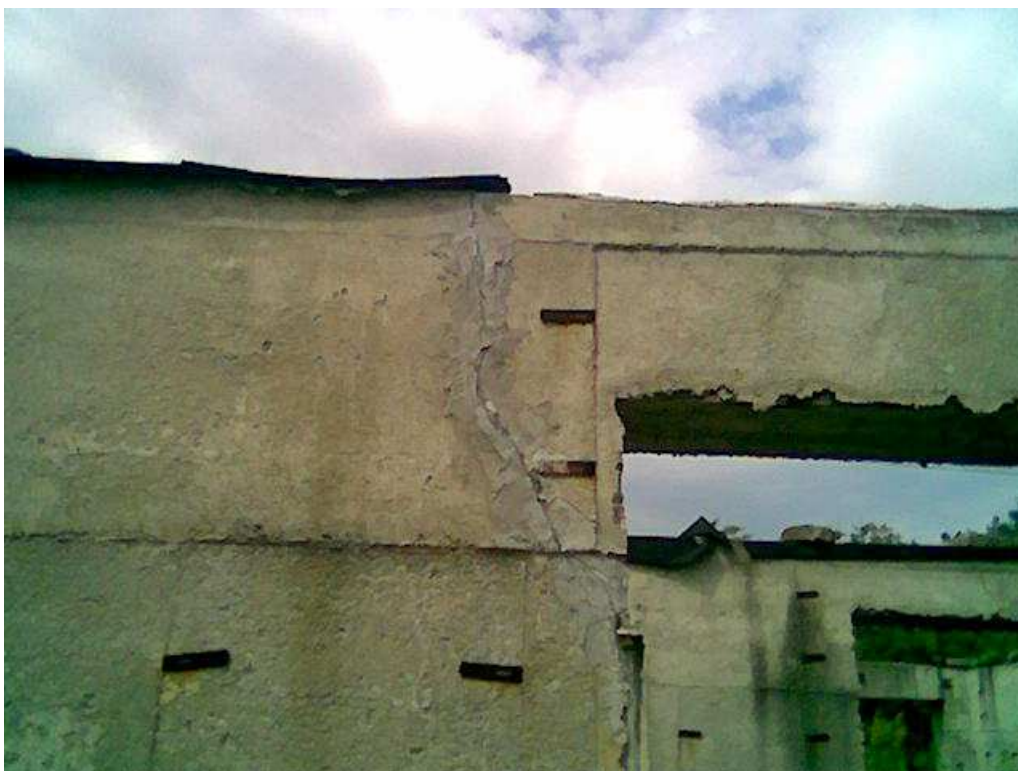
Fot. 5. Rysa ukośna przy nadprożu nad otworem drzwiowym.
