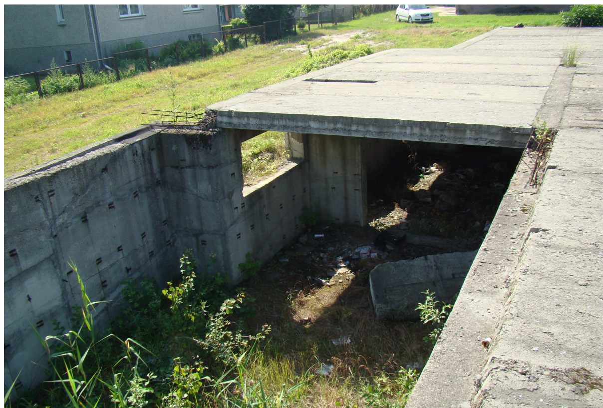
Fot. 14. Fragmenty niewykonanych stropów.
