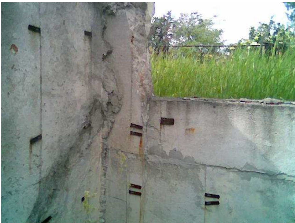
Fot.7. Rysa ukośna na ścianie prostopadłej do otworu okiennego – przy ścianie zachodniej.
