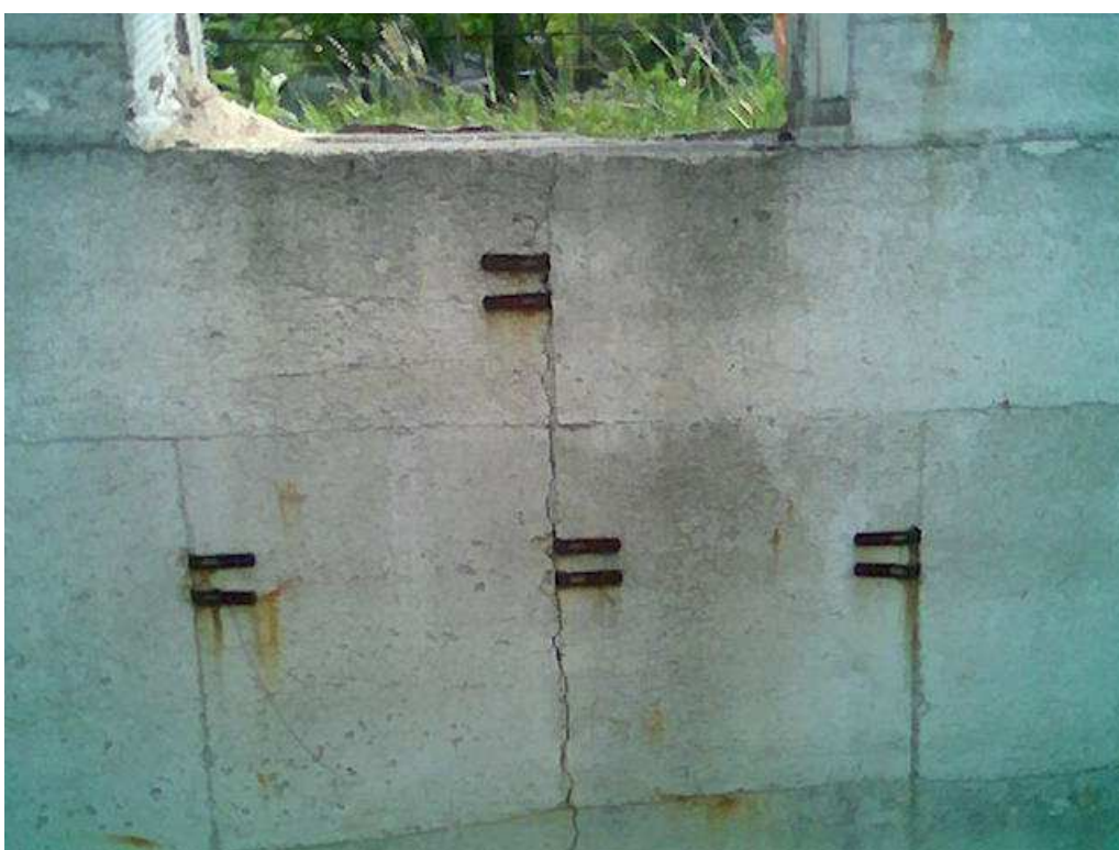
Fot. 4. Rysa pionowa pod oknem na ścianie zewnętrznej wschodniej.
