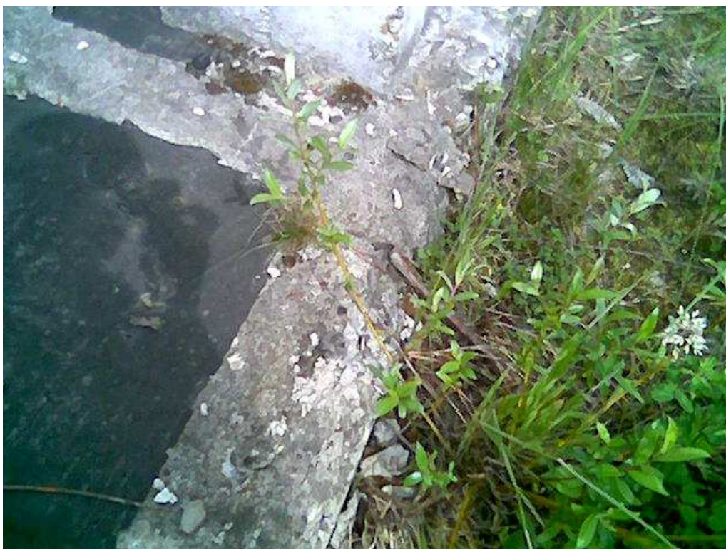
Fot. 1. Uszkodzenie izolacji poziomej i górnej warstwy ławy.
